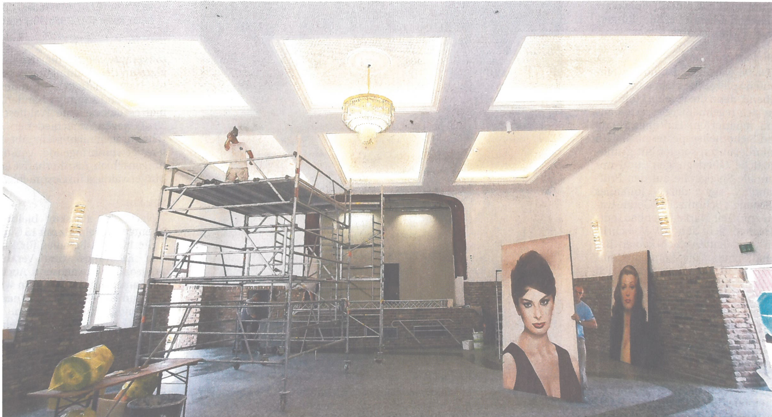
Der Leuchter hängt an der neuen Decke, die Bilder werden hereingetragen – der Saal des Kamper Hof s war gestern ( fast ) fertig.
