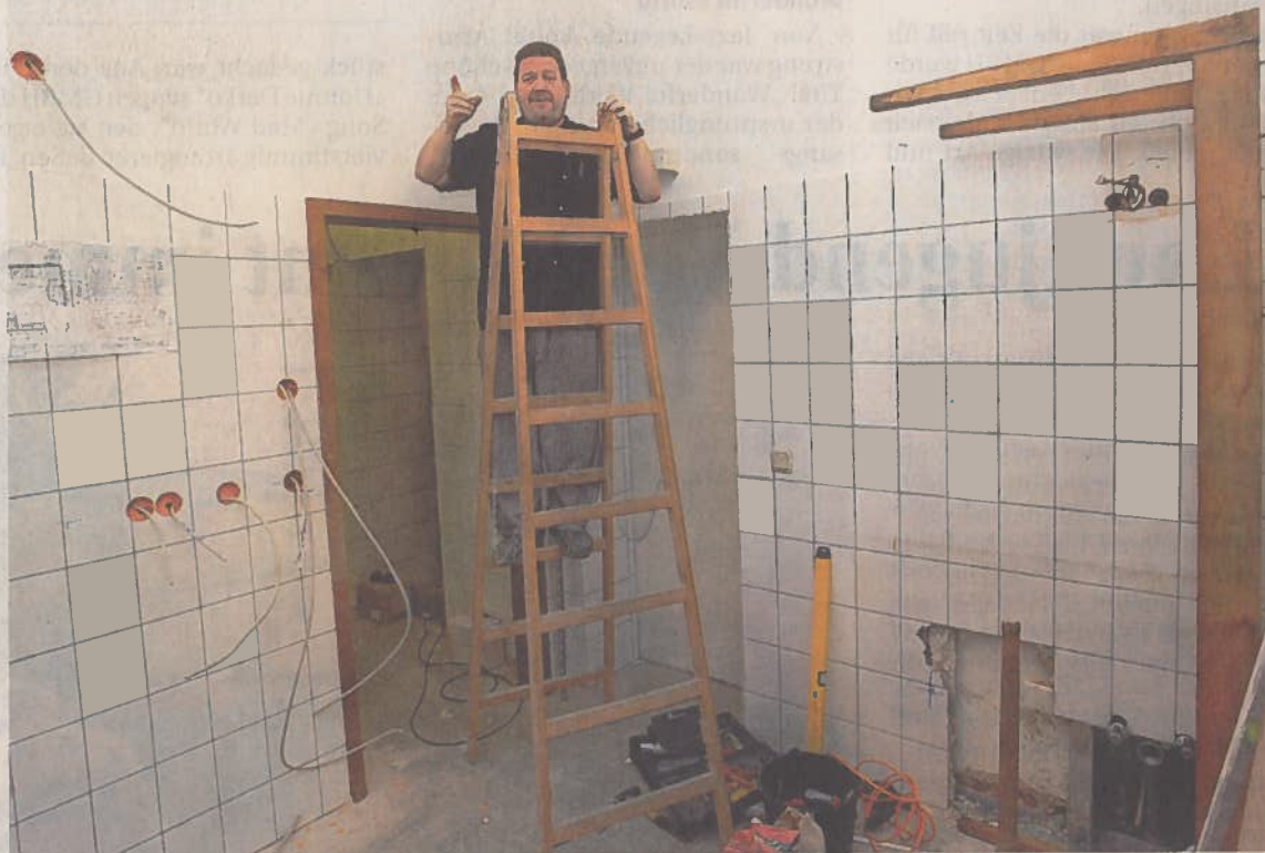
Hier wird Pio demnächst kochen: Der Umbau des alten „Köpi-Stube“ geht im historischen Kamper Hof gut voran, demonstrierte Gastronom Ralf Piotrowski gestern.
